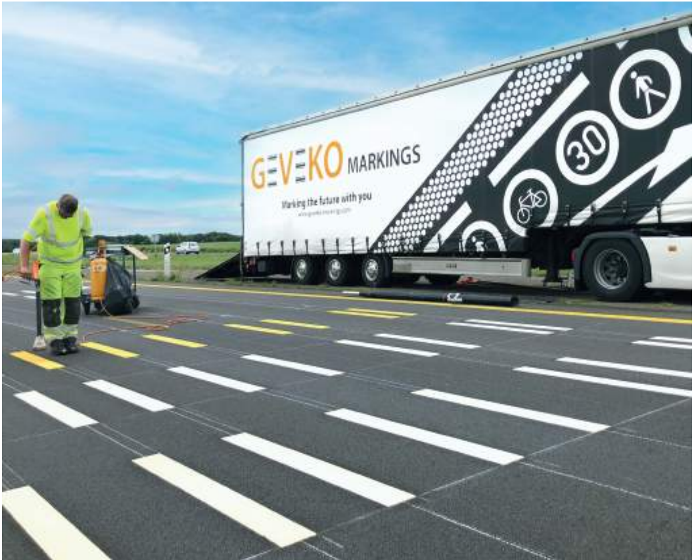
Notre service technique sur le site de certification (RN2)
